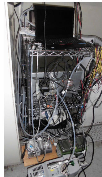
図5 堺市役所での計測機器の設置状況
